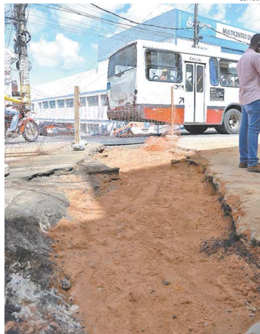
Cratera na Estrada da Liberdade reabriu, mas reparos foram concluídos
